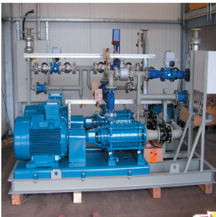
Equipos de bombeo y control sobre bastidor.
